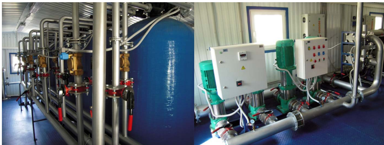
Рисунок 10. Блочно-модульная установка очистки воды
