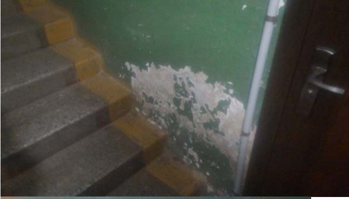
Текущее состояние подъезда, полная антисанитария
